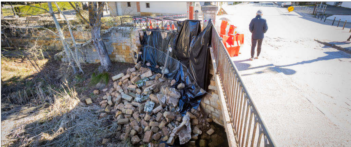
Situación del Puente de Piedra en la mañana de ayer con los restos del desprendimiento aún visibles. MARIO TEJEDOR
